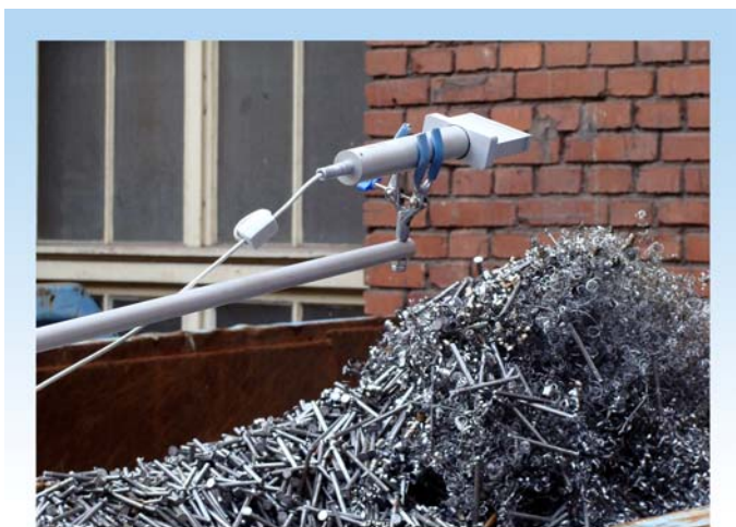
Teleskopadapter mit NaJ-Szintillationssonde 2002 zur Kontrolle von Stahlschrott auf radioaktive Kontamination
